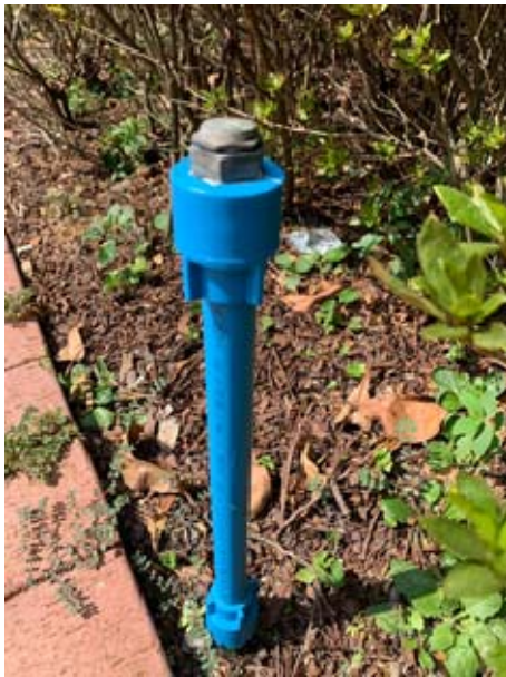
圖一：地上部分連接噴嘴之水管應採用高密度聚乙烯喉管或具同等質量之軟膠喉管，每隔 3 米安裝一個可調教 180°角銅噴嘴，膠喉一般高出泥面 30 公分。
